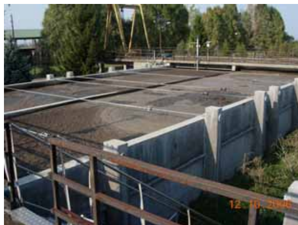
Aeracione lagune i taložnici na postrojenju
